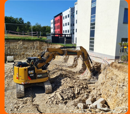
Ein 25-t-Kettenbagger und eine Querschneidkopfräse EKT 100 von KEMROC beim Unterfangen eines Gebäudes im Technologiepark von Paderborn.
